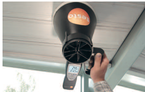
Kontrolle der Zuluft an einem Tellerventil
